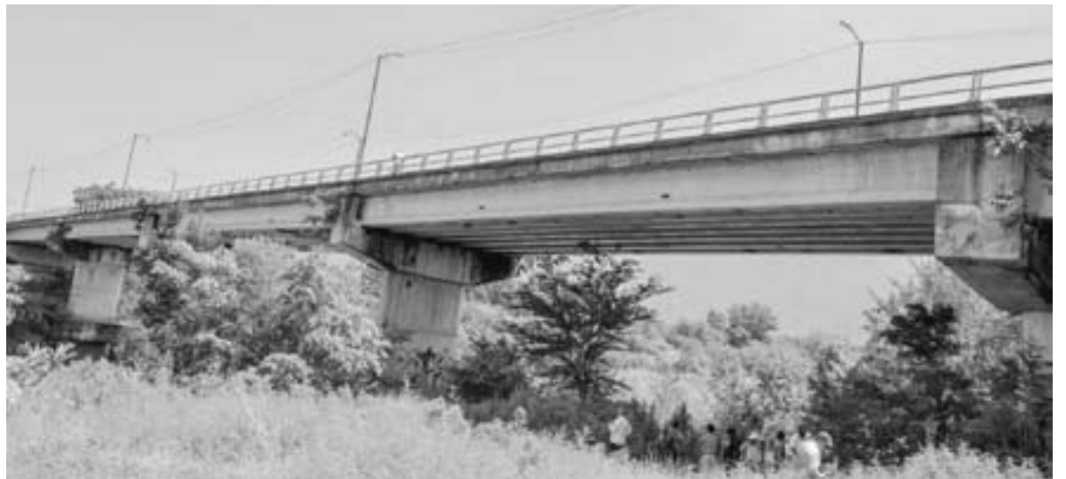
Los habitantes de la zona desde hace un año denunciaron las afectaciones del puente. Rafael Victorio / CP
