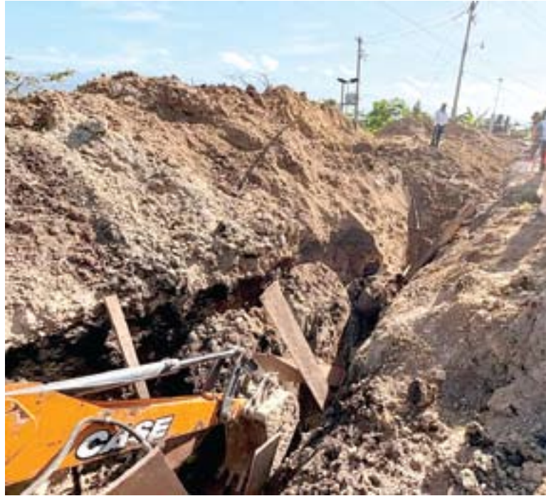
Las autoridades investigarán las causas del colapso. Cortesía
