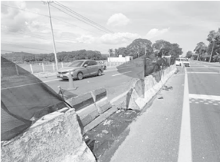
Hubo daños en la estructura vial, aunque no personas heridas. Rafael Victorio / CP
