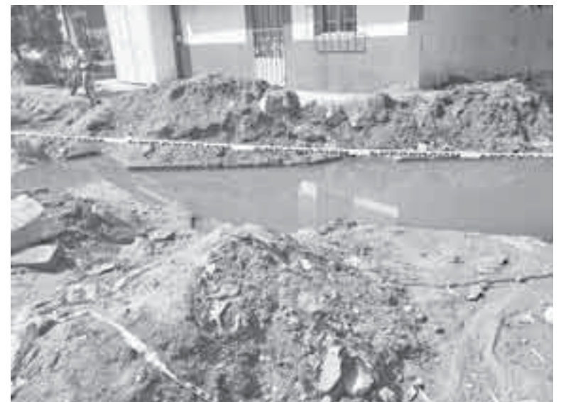
Aspecto de las calles afectadas. Rafael Victorio / CP
