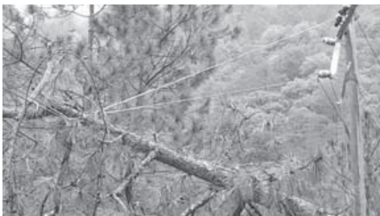
La falla se debió a la caída del árbol sobre la línea eléctrica. Manuel Martínez / CP
